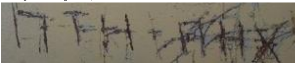
Рисунок 5. Вертикальная поверхность, изготовленная из металла, надпись выполнена металлическим гвоздем
